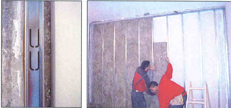
Fotografías 12 y 13 Separación de la segunda estructura y colocación de la lana mineral en su interior
